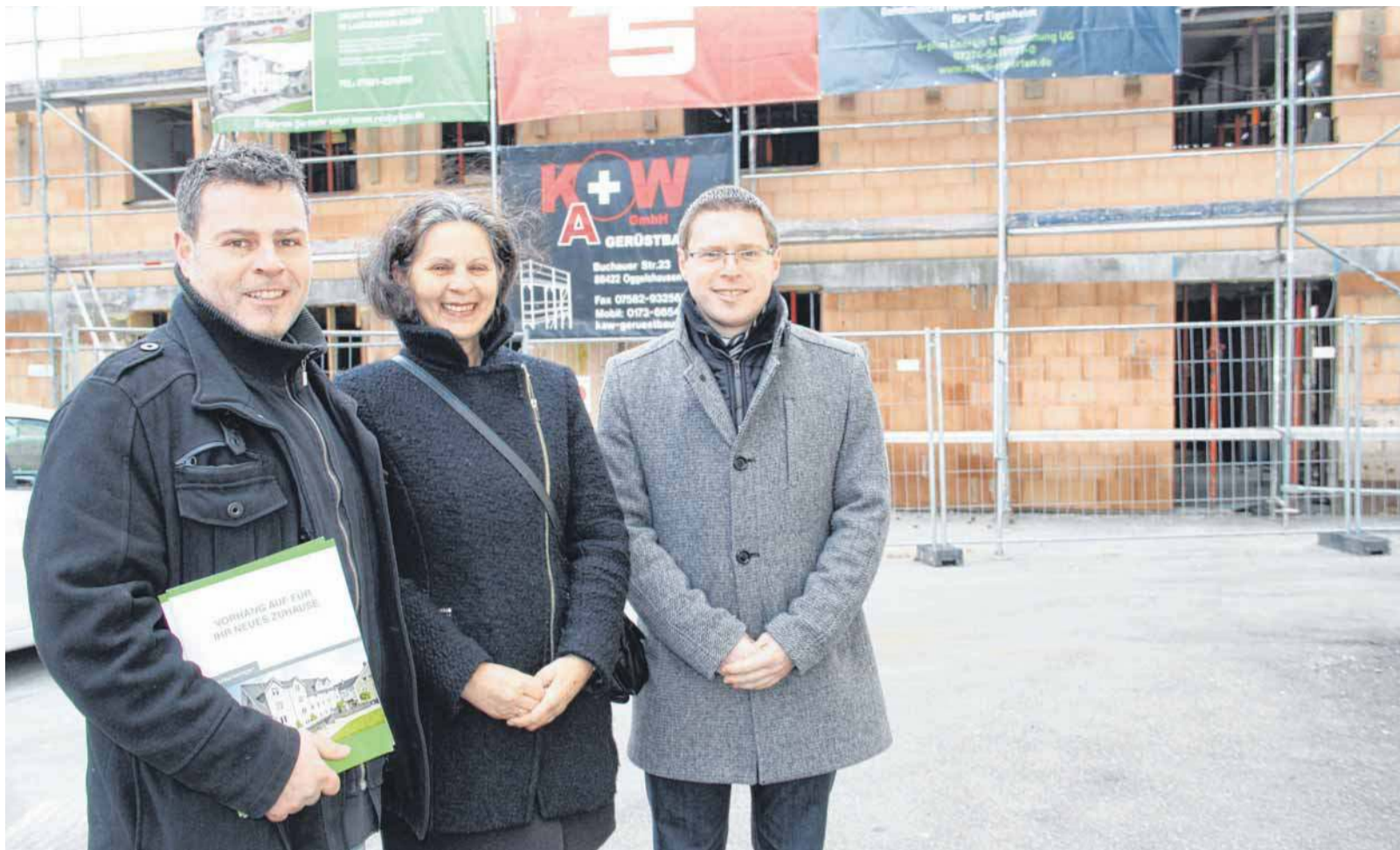
Betriebswirt Thomas Haag, Architektin Gabriele Kittel und Bürgermeister Andreas Schneider vor dem neuen Drei-Generationen-Objekt in der Hauptstraße.
